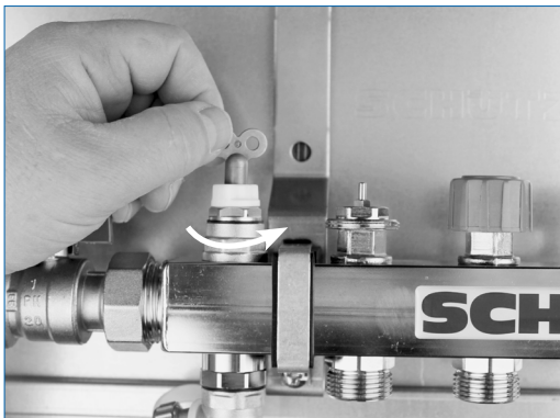
Nach erfolgreicher, blasenfreier Durchspülung beide Ventile Vor- und Rücklauf schließen.
