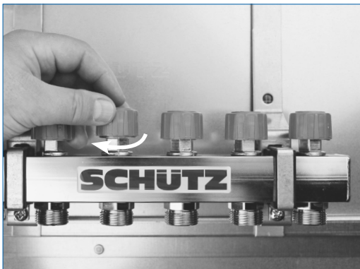
Alle Vor- und Rückläufe absperren.
