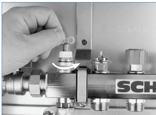
Después de un lavado correcto sin burbujas, cerrar las dos válvulas de impulsión y retorno.
